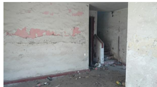
Imagen 8, 9 y 10 Fotografía actual, Casa 7. Arquitectura en deterioro
